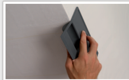
12 Pour les angles sortants, passer la spatule sur l'angle de façon à assouplir le revêtement.
